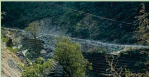
شکل ۴- حفاظت دیواره خاکریزی ناپایدار (پاسکوال، ۲۰۰۱)
