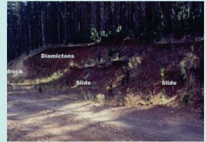
شکل ۲- لغزش دیواره خاکبرداری جاده (ارسکین، ۲۰۰۵)
