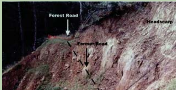
شکل ۵- تخریب جاده بر اثر زمین لغزش (ارسکین، ۲۰۰۵)
