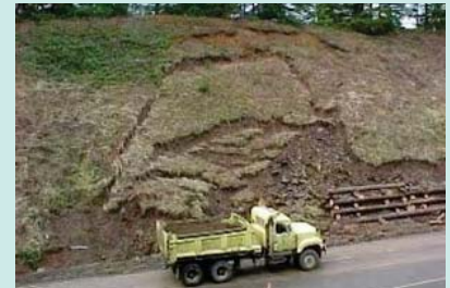
شکل ۳- ناپایداری دیواره خاکبرداری جاده (لويس و همکاران، ۲۰۰۱)
